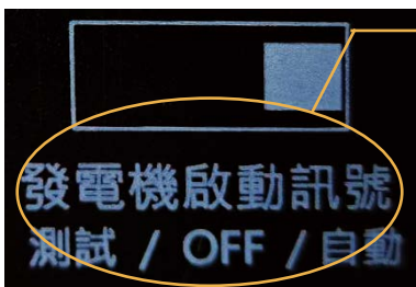
發電機啟動訊號測試 (只單獨測試發電機)
