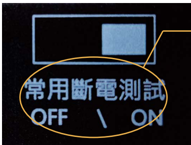
常用斷電測試 (斷電模擬測試--測試 ATS切換動作不關總 開關)
